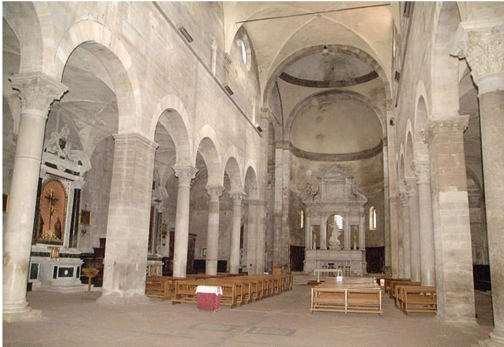
Una prospettiva della chiesa: nelle volte immediatamente prima e sopra l'altare sono evidenti infiltrazioni
