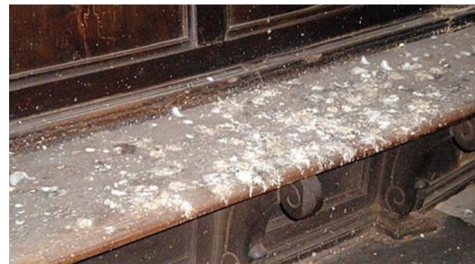
Particolare dell'interno della chiesa infestata dai piccioni
